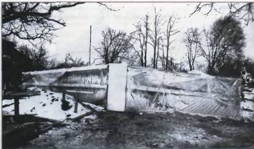
До начала морозов застраиваемый участок по деревянному каркасу был накрыт полиэтиленовой пленкой
