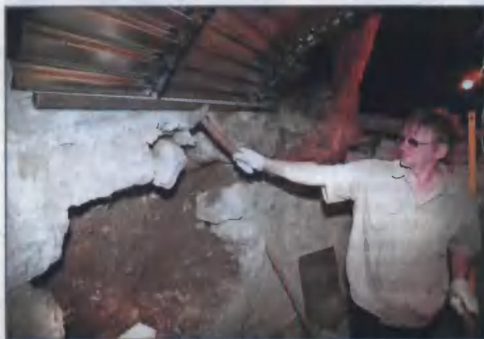
Стена, примыкающая к склону, требовала ремонта. Пришлось часть стены разобрать
