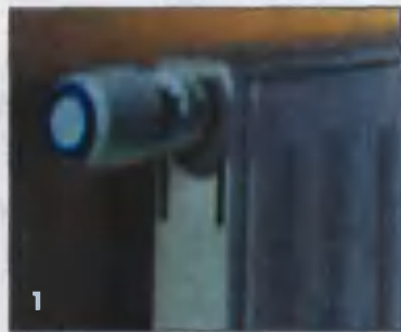
Отопительные батареи в доме оснащены термостатными вентилями
